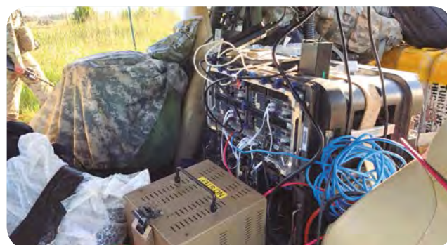
Despliegue de nodos del Data Center Táctico
